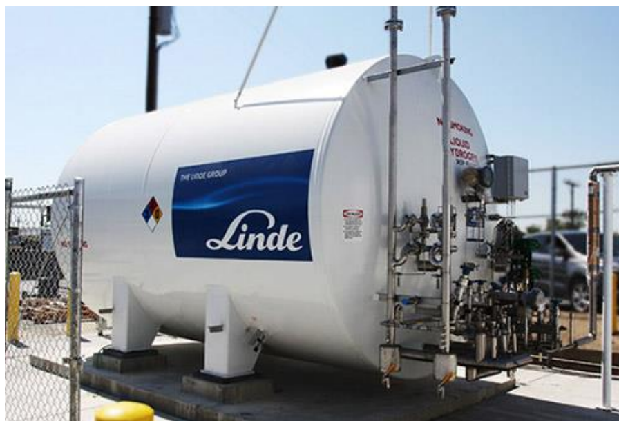
Figura 41: Tanque de hidrógeno líquido.
