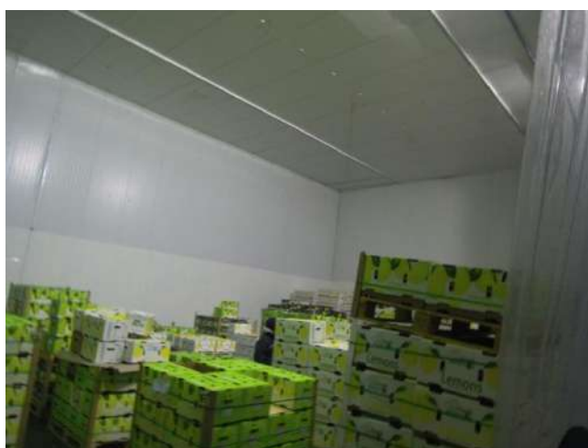
Ilustración 50: Vista cámara de frío, planta Gesex (Buin).
