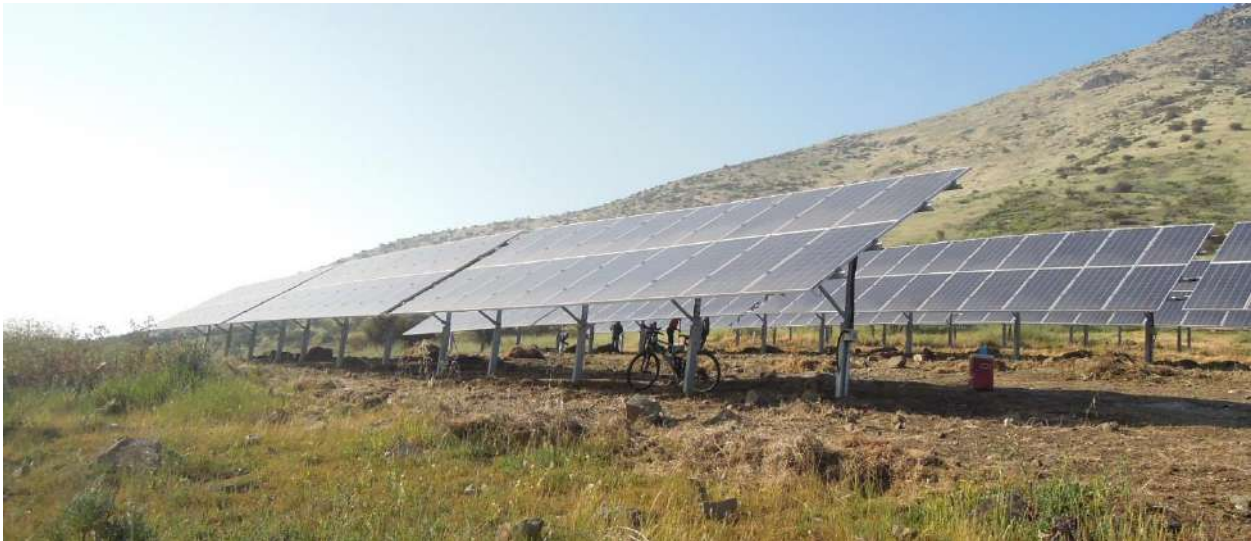
Ilustración 64: Vista proyecto fotovoltaico Agrícola Aeropuerto (Fuente: Visita 02-09-2016).
