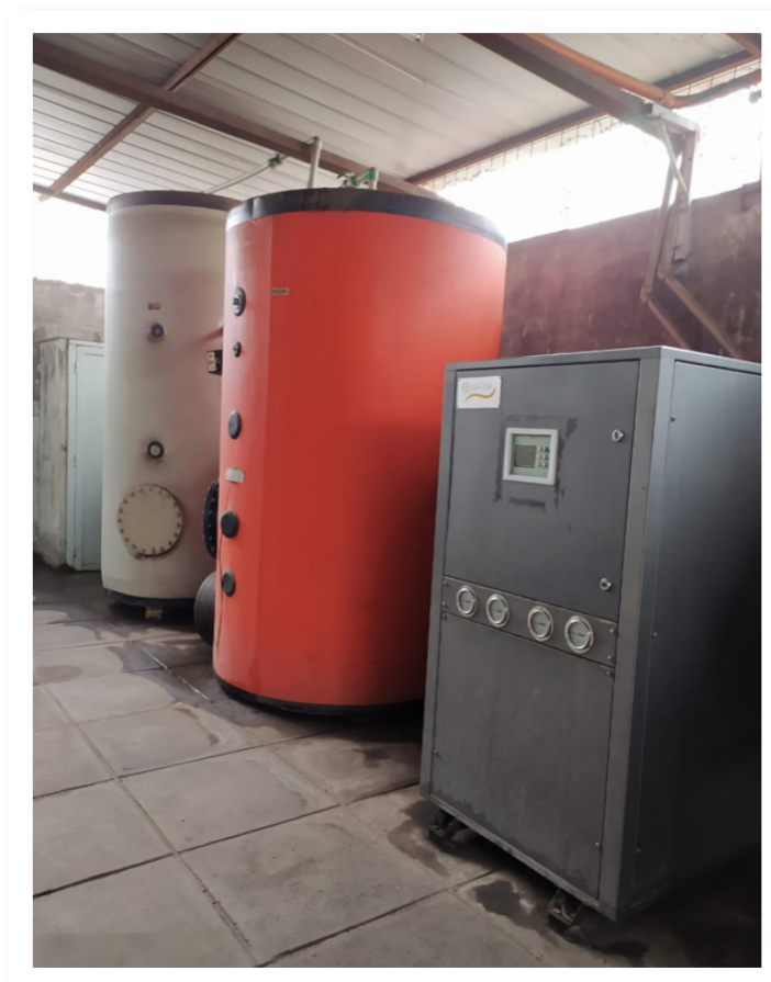
Figura 16: Bomba de Calor, Unifrutti, Chile. Fuente [9]: Unifrutti, 2012.
